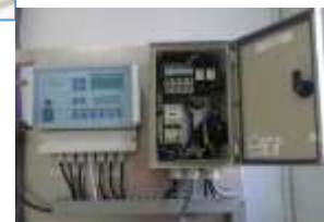
Armoire électrique et écran LCD de contrôle
